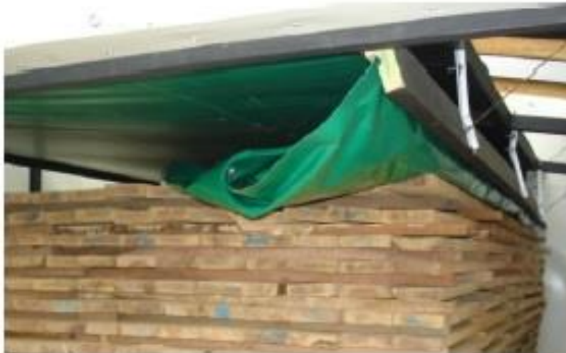
Detalle de instalación y ubicación del baffle
