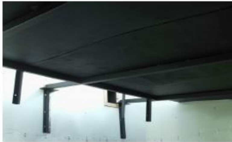
Detalle de soportes del colector y colector
