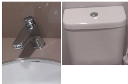
Cachera con sistema de temporizador y sanitarios de doble caudal
