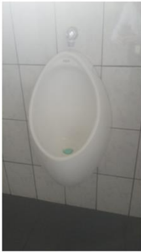
Imagen No.1 Mingitorio seco instalado
